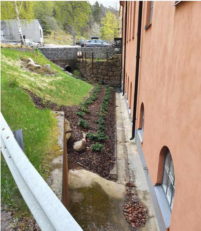
Figur 28. Norra delen av hus B. Ränna för avrinning av dagvatten från takyta.
