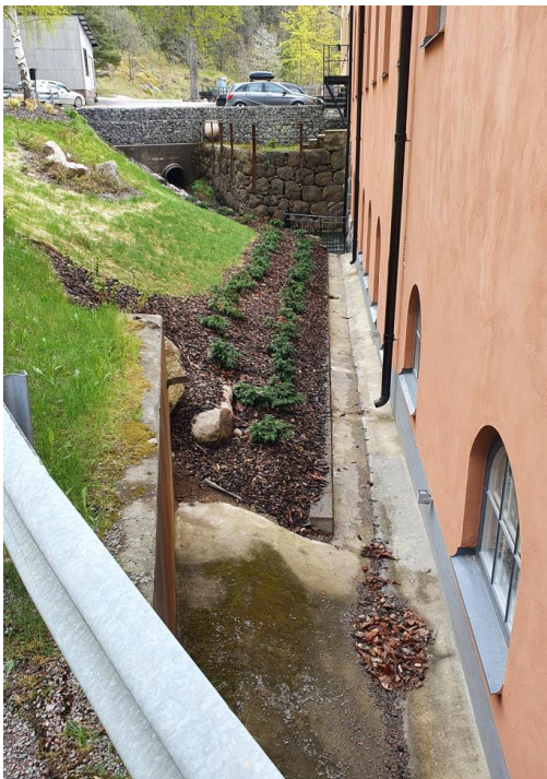
Figur 10. Stuprör på Vigognespinneriet där avrinningen av takvatten leds i en ränna ned i kanalen.
