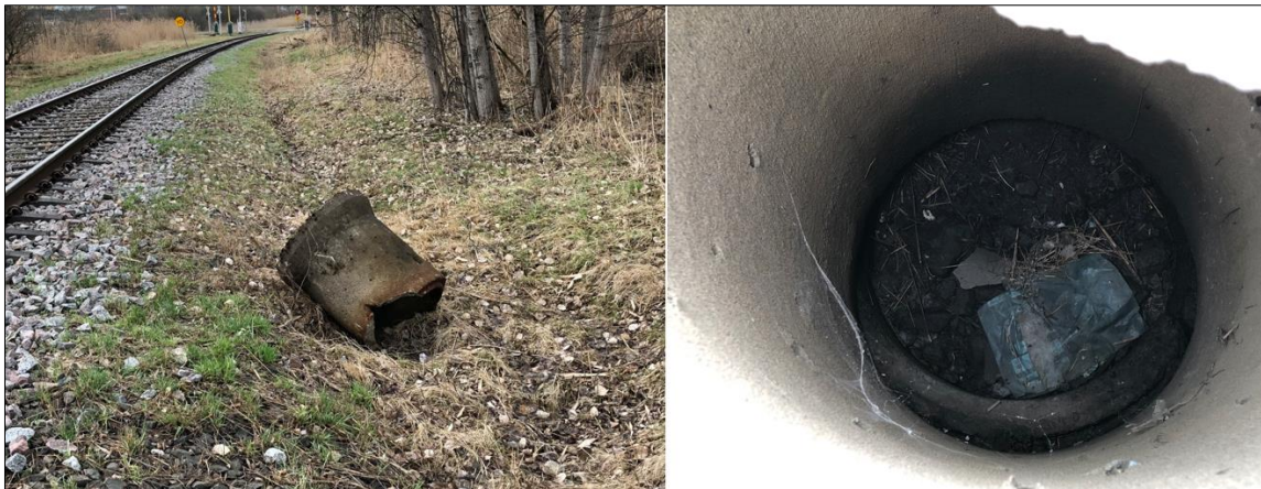
Figur 9 – Befintliga brunnar längsmed järnvägen. Bild till höger är botten på en av brunnarna vid banvallen i anslutning till Kommendantvägen där botten är helt igenfylld.
