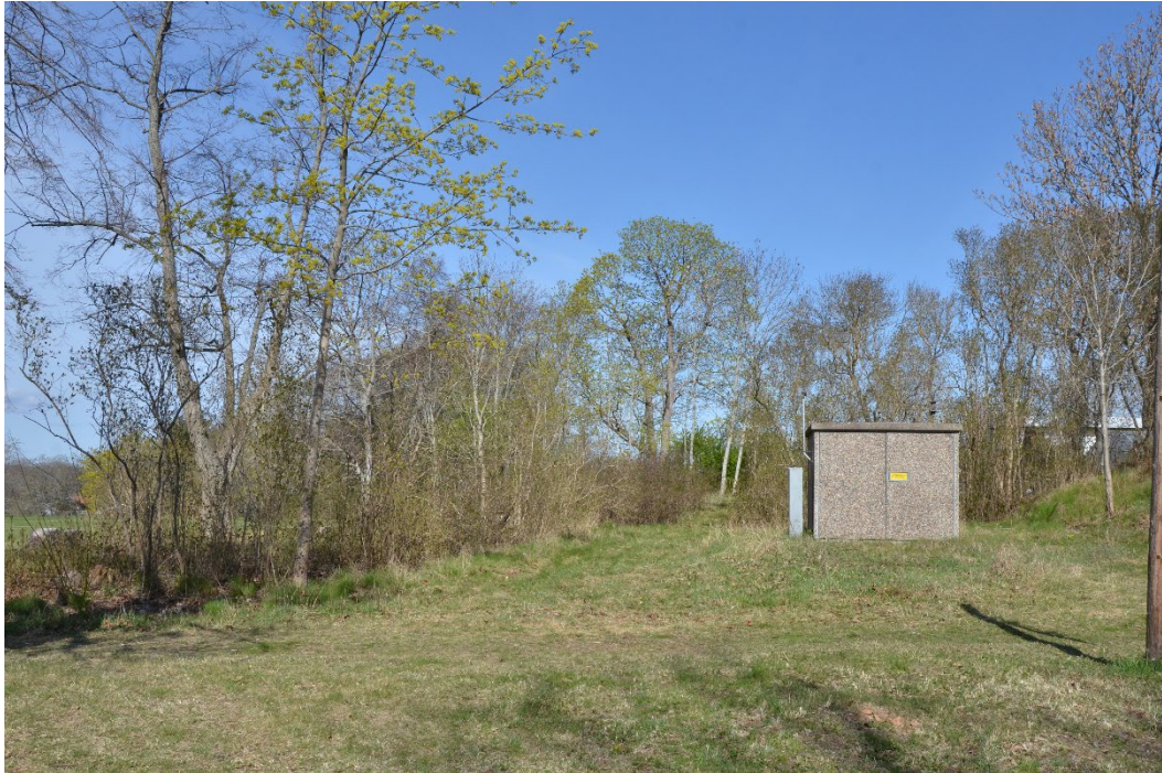
Figur 10. I bilden syns transformatorstationen på Kuttern 10.
